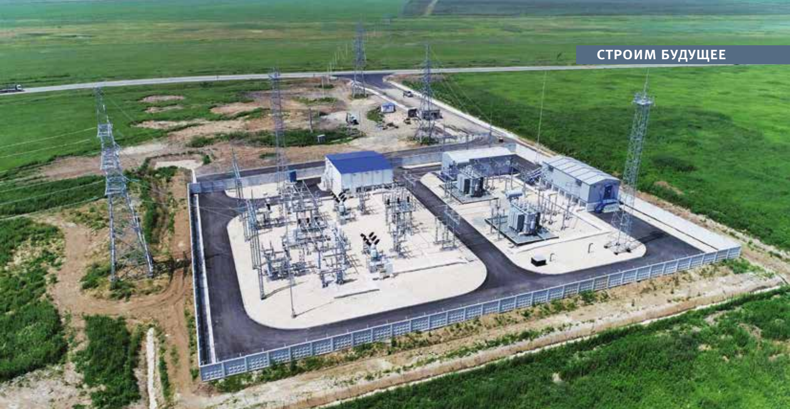
Подстанция 110 кВ «Агрокомплекс»
