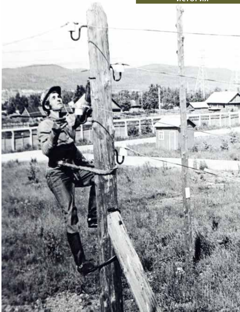
ЛЭП 04 кВ. Комсомольский район, 60-е г. 20 в.
