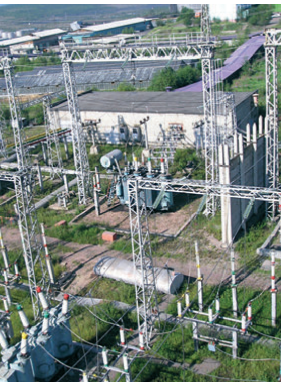
Самая мощная подстанция в Республике Саха (Якутия) установленной мощностью 136 МВт – «Обогатительная фабрика», с которой запитаны объекты компании «Якутуголь»
