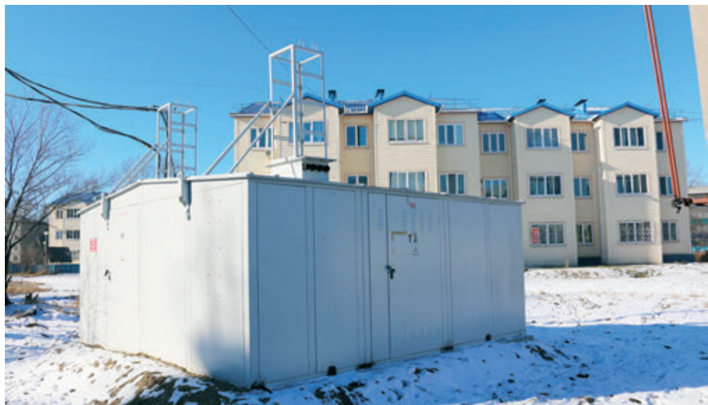
Новые ТП для многоквартирных домов
