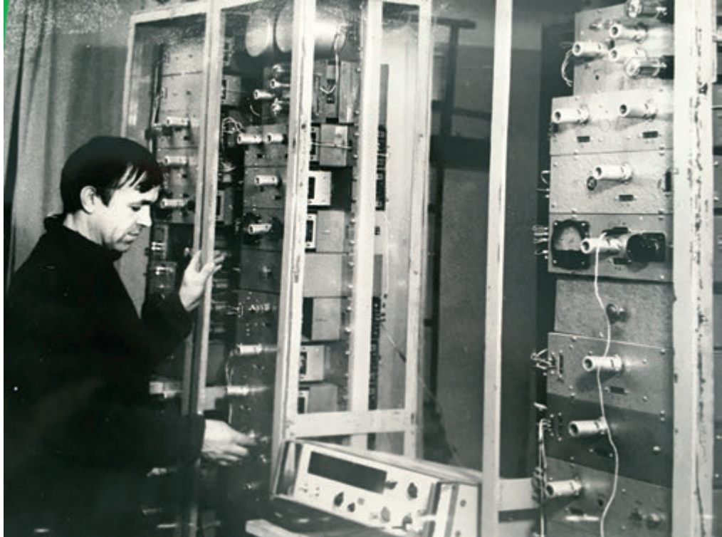
Комната связи ПС «К»
