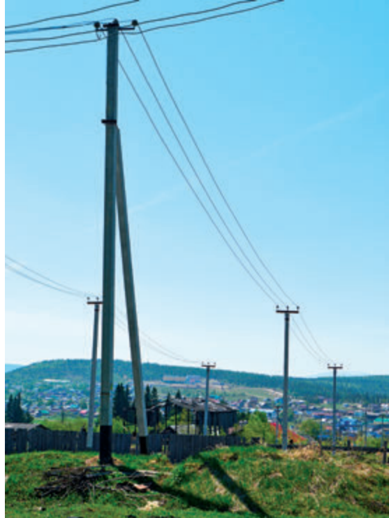
ЛЭП 6 кВ для электроснабжения базы линейного производственного управления, узла подключения очистного устройства и газораспределительной станции ПАО «Газпром» в Алданском районе
