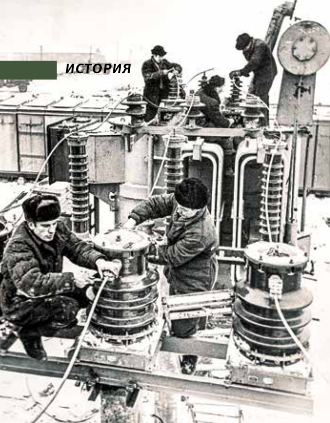
Бригада за наладкой оборудования на подстанции
