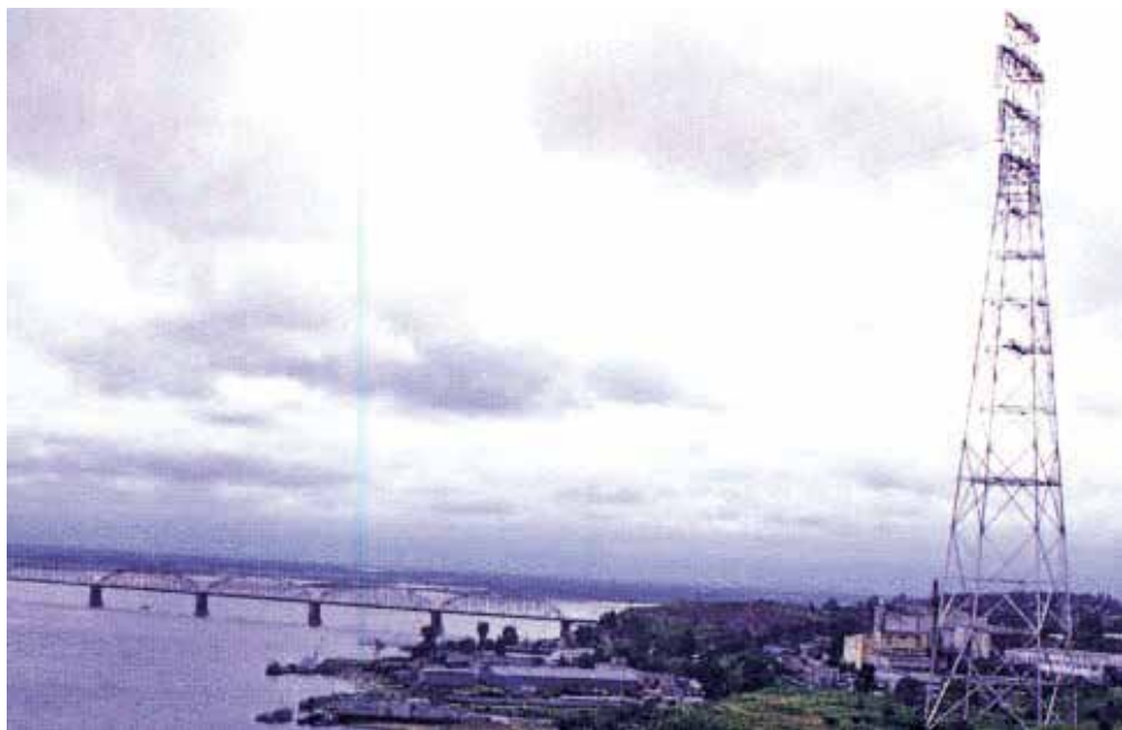
Переход 220 кВ через р. Амур
